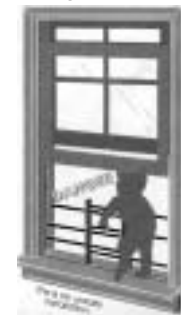
PELIGRO Esta es una reja de seguridad mal instalada
