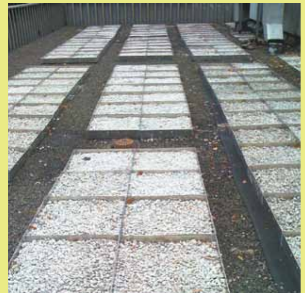
Las bandejas azules se han instalado en el tejado del Centro comunitario de Bronx River Houses para desacelerar la velocidad con que bajan las aguas antes de depositarse en el sistema municipal de alcantarillado.
