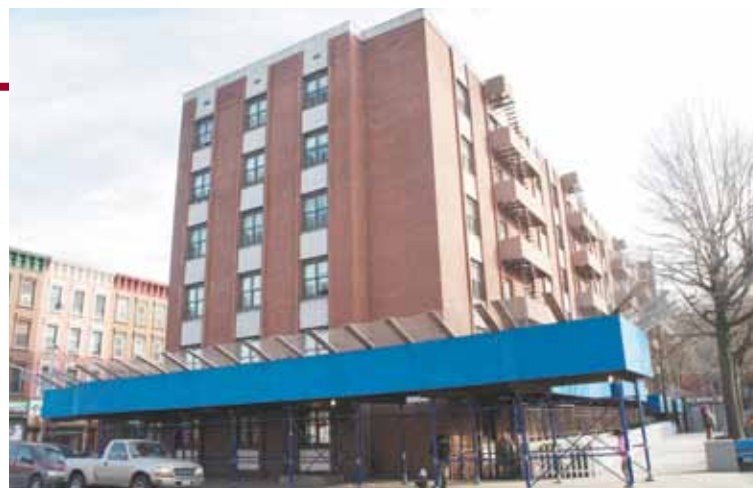
El residencial Armstrong Houses ubicado en Brooklyn, muestra parte de su nueva fachada que se pudo realizar con fondos federales de estímulo económico, mientras continúa la labor de rehabilitación.
