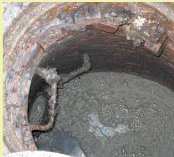
Se puede ver la acumulación de grasa en la superficie de las cloacas de la Ciudad de Nueva York mientras los equipos de NYCHA limpian las tuberías cerca del Residencial Baruch Houses el 8 de enero de 2013. Foto de Daniel Osgood.
