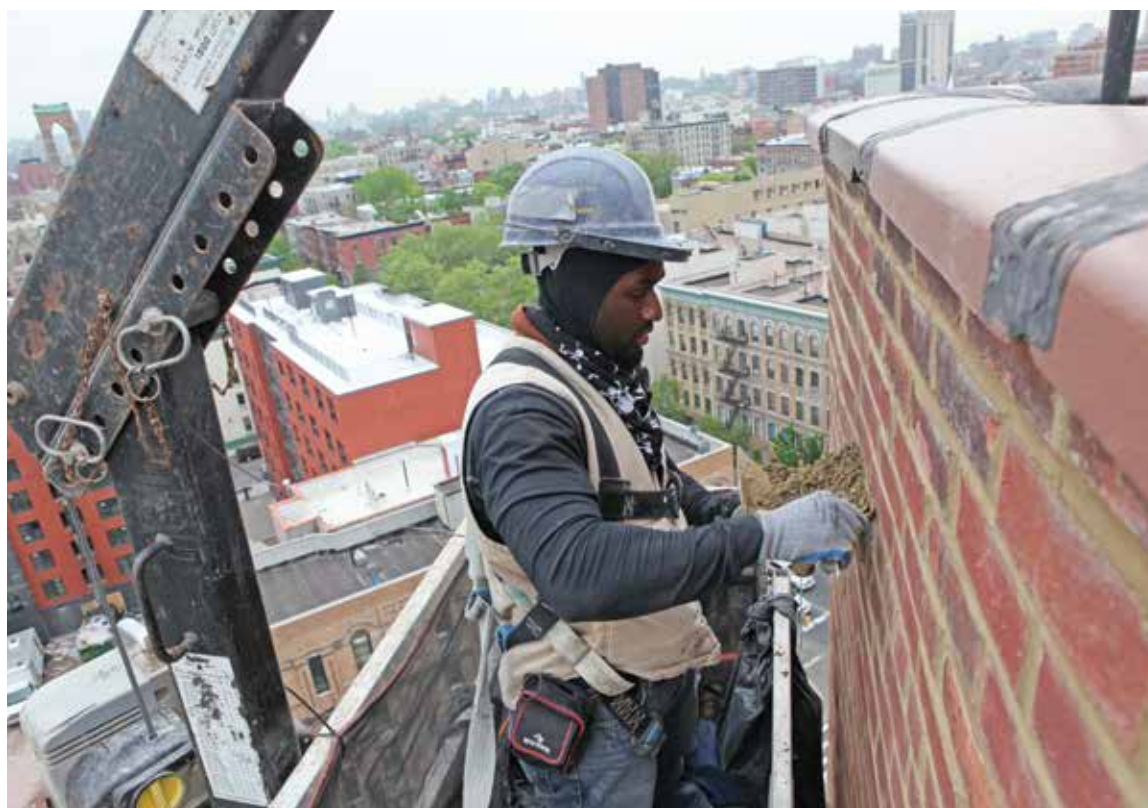
El dinero que NYCHA recibió del gobierno federal se utilizará para mejoras de capital, incluso tareas de mampostería en exteriores.
